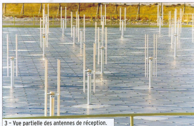
3 - Vue partielle des antennes de réception.
